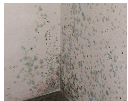
Schimmelpilzwachstum in einer Kellerecke
